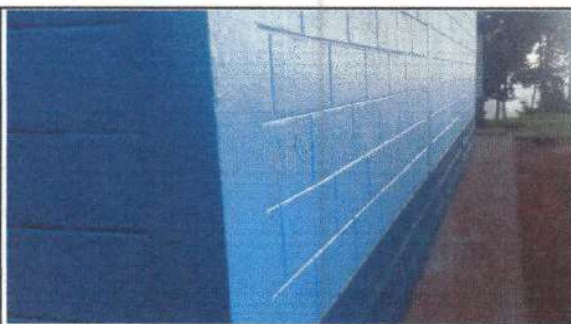
Foto 4: Pintura exterior de la pared de todas las aulas.
